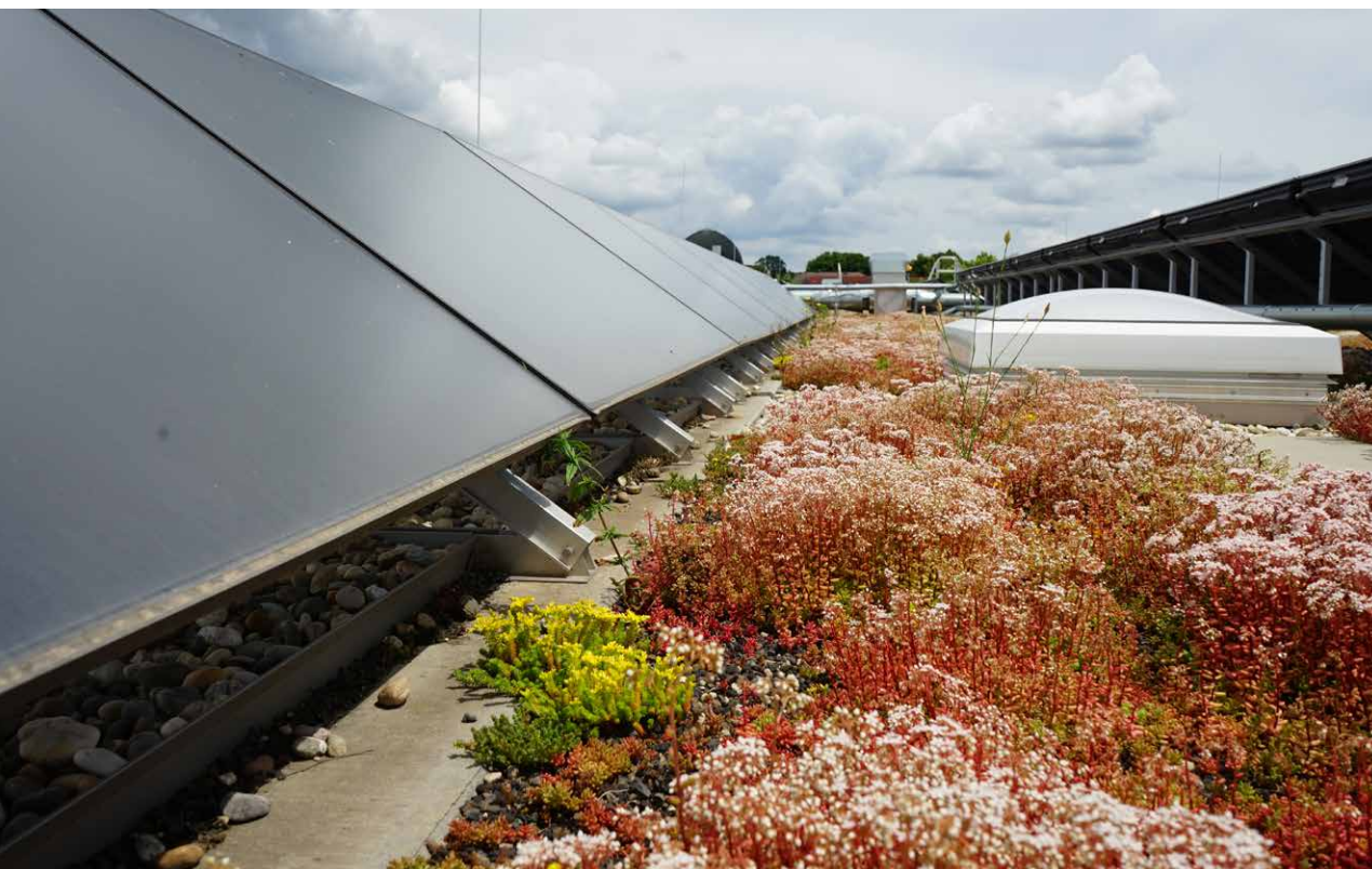
23 Solarthermie-Anlage auf dem Dach der Wohnanlage „rest“
